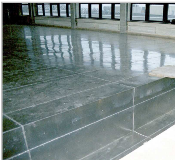
Bodenabschirmung, Trafostation im UG
